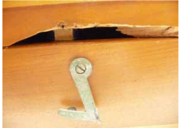
〔格納箱の蓋の手前左側の割れ〕
